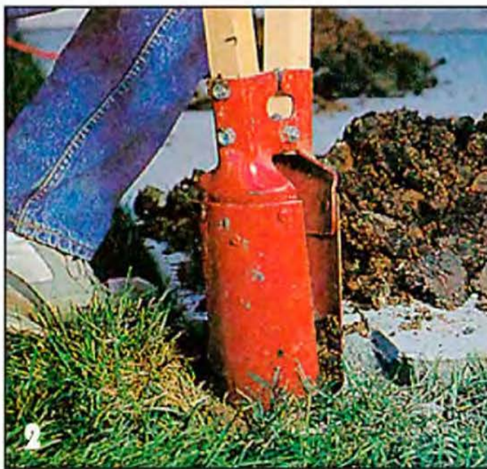
Для выкапывания скважин под опорные сваи пользуются садовым буром или специальной лопатой. На дно скважин отсыпают слой щебня.
