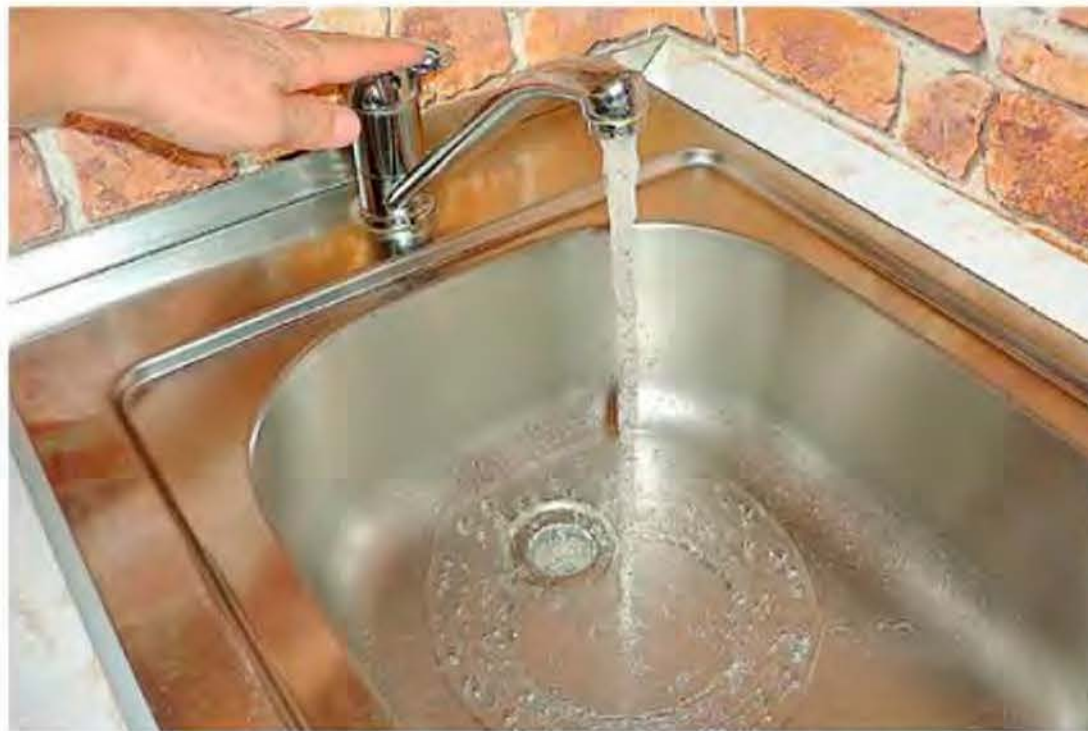
Финишная операция, которую выполняют после установки нового сифона. Открыв кран с водой, проверяем все соединения сифона на течь.
