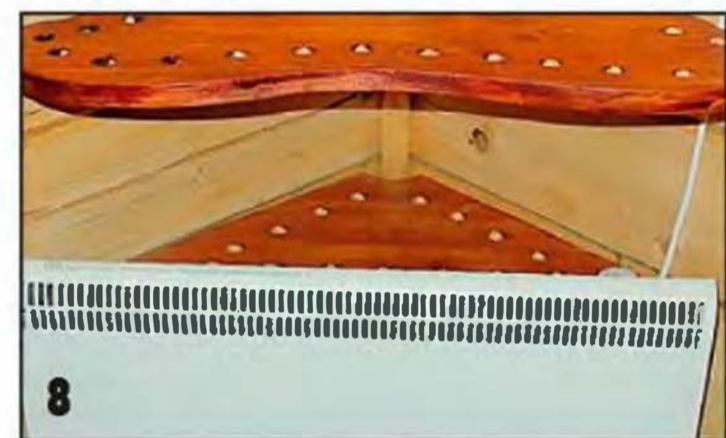
Установленный в шкаф электрический конвектор сушит одежду и обувь. Чтобы на пути нагретого воздуха было меньше препятствий, в полках просверлили отверстия.
