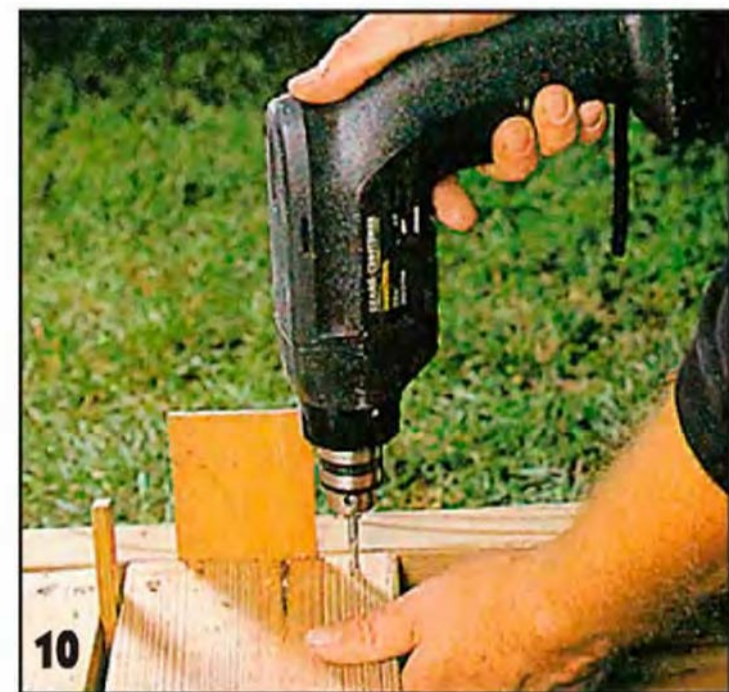
При укладке половых досок пользуются прокладками. Прокладками толщиной 10 мм формируют ровные щели между досками, а прокладками толщиной 3 мм — зазоры между торцами половых досок и наружным каркасом.
