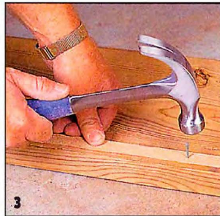
Если между домом и бетонной плитой есть зазор, его заделывают обрезком доски соответствующего размера.
